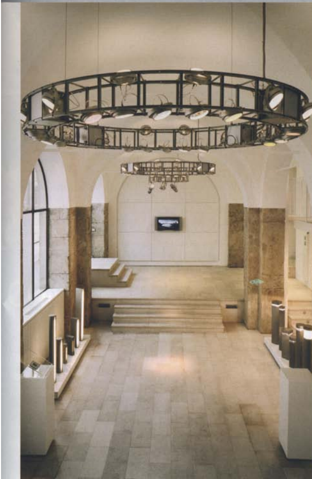
SOLUZIONE Una rete di schede elettroniche con 12 relè e relativi dimmer sono collegate tramite un cavo di segnale schermato 2 x 0.35
